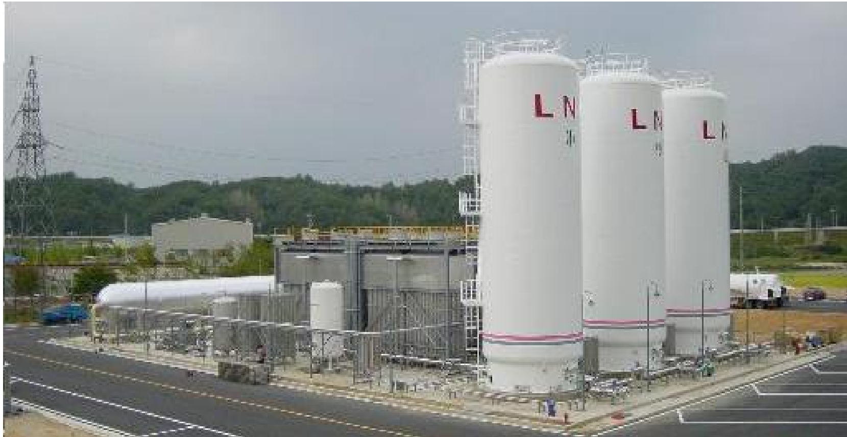
LNG Satellite Facility
