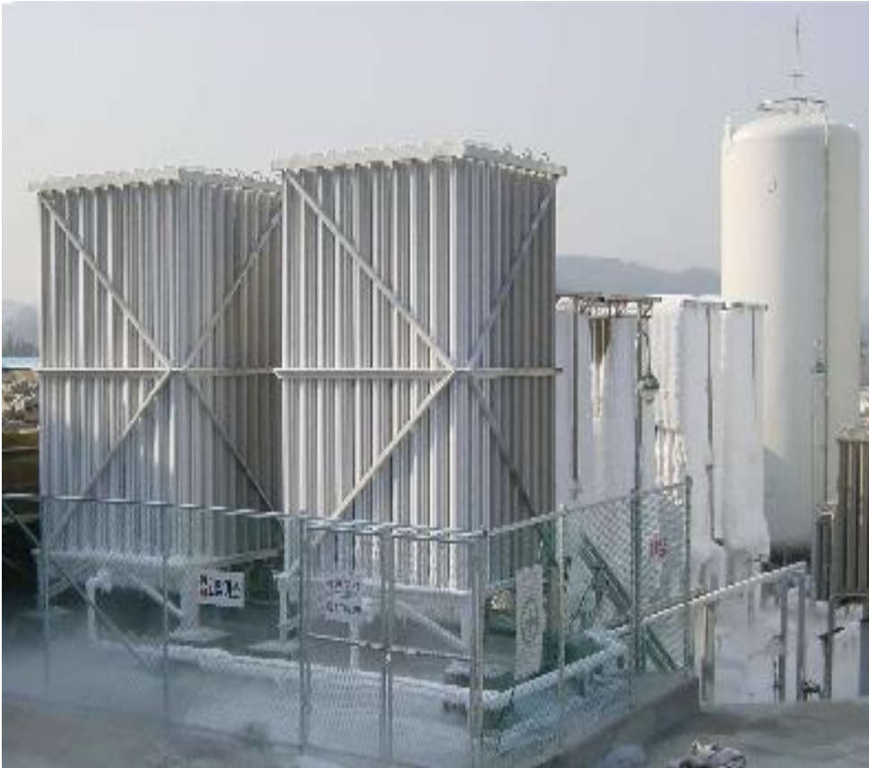
Extra Gap Ambient Vaporizer for LNG
