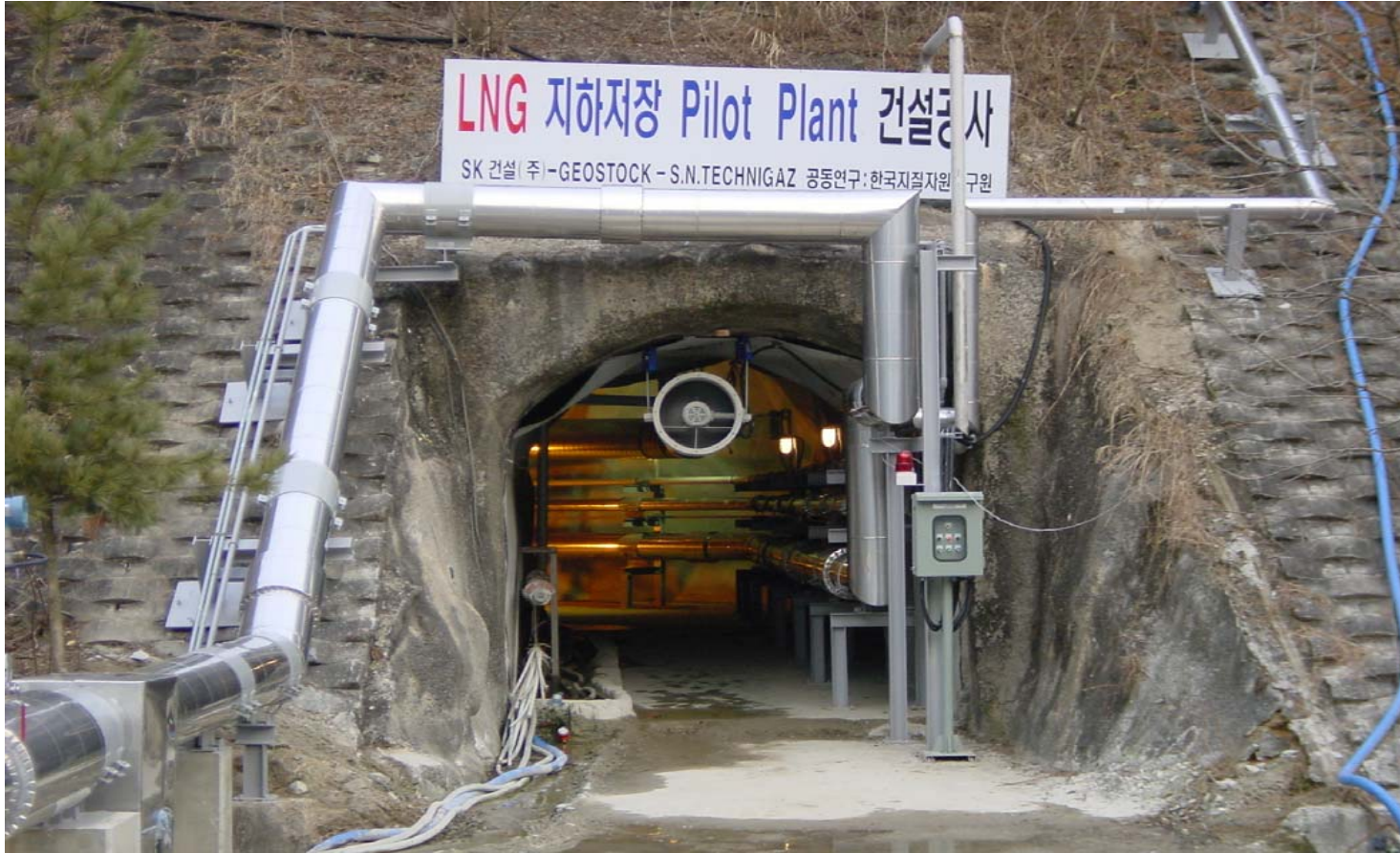
LNG U/G Storage Pilot Carven Plant for LNG Storage Research & Development
