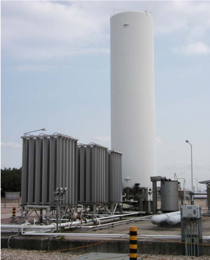
Nitrogen System for LNG Terminal
